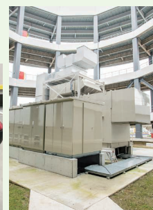
自家発電設備
