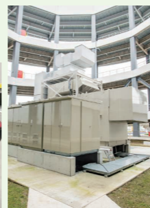
自家発電設備
